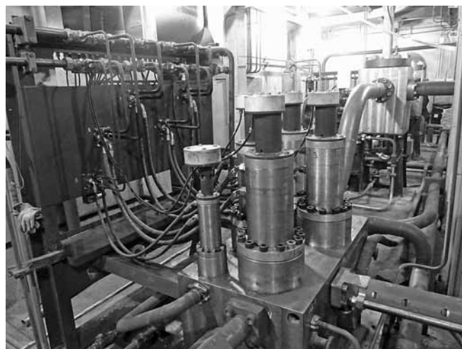
Рис. 4. Фрагмент гидрооборудования гидросистемы штамповочного прессы двойного действия П4654 силой 40/65 МН после модернизации
