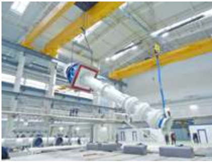
Вертикальные подпорные насосы испытательного центра (АО ТНН)
