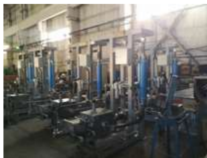
Блоки управления гидросбивом с пневмоуправлением
