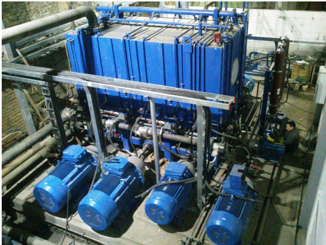
Насосная установка высокого давления
