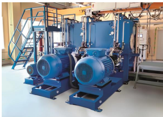
Рис. 3. Общий вид насосно-аккумуляторной установки стенда
