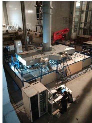
Рис. 1. Общий вид УТЦВ с макетом КА, установленным на УПП, в процессе пусконаладочных работ стенда
