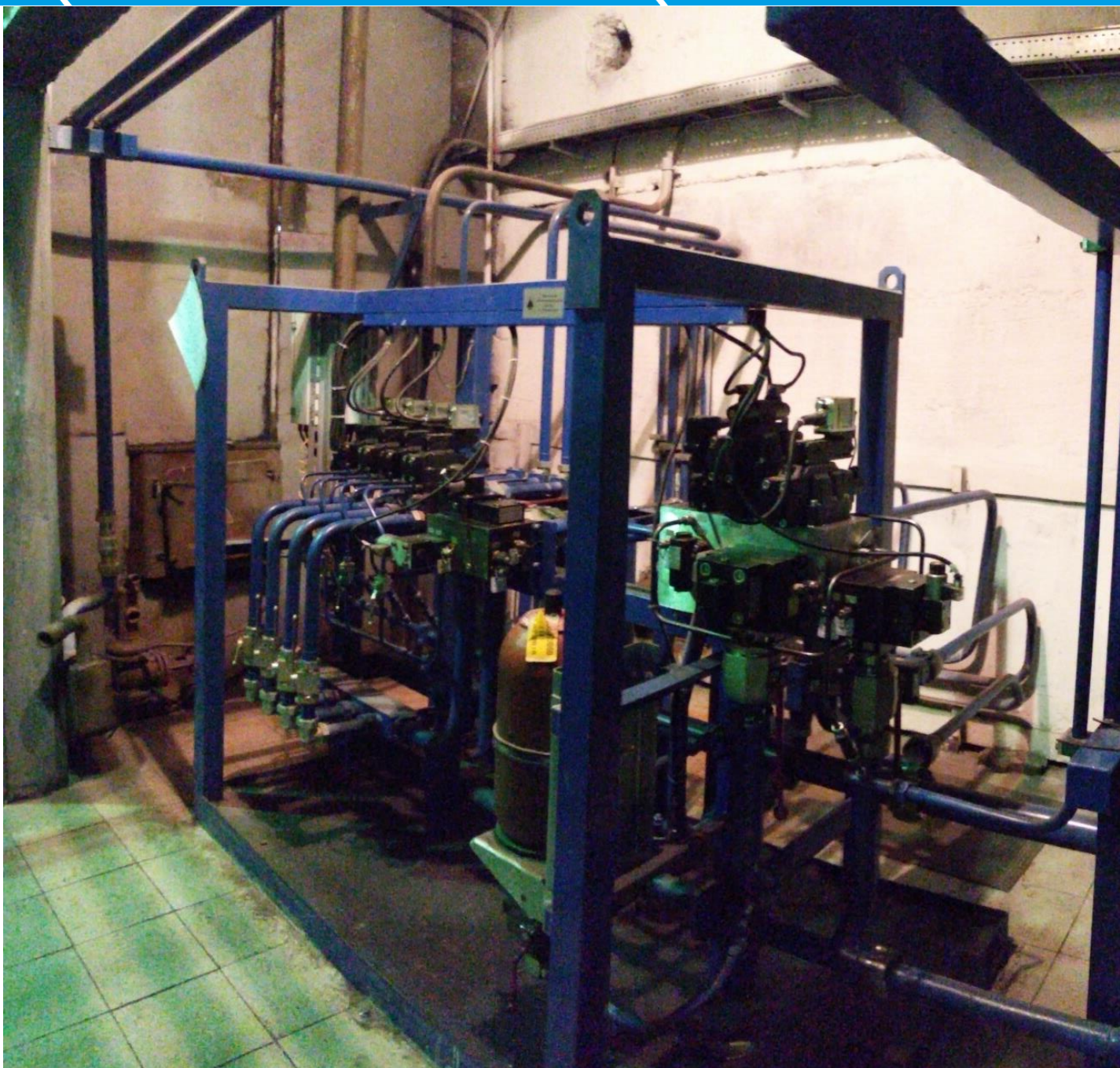
Панель управления ДСП-25 (Ижевск)
